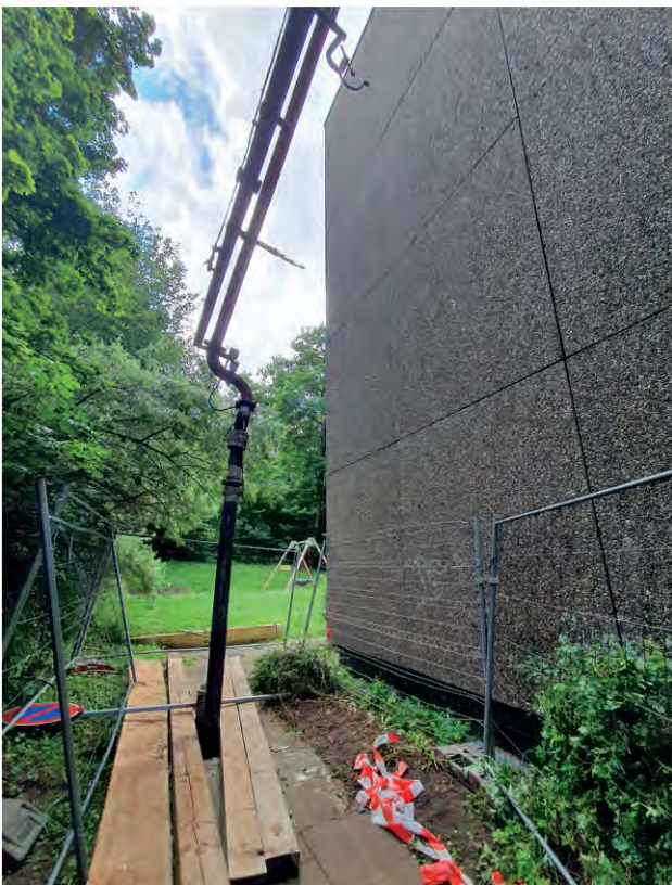
Bilder 10.5 und 10.6 – Tagesbruchsicherung unmittelbar neben einem Wohngebäude
