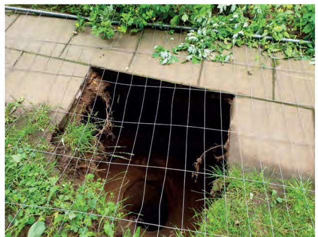
Bilder 10.3 und 10.4 – Tagesbruch neben einem Wohngebäude
