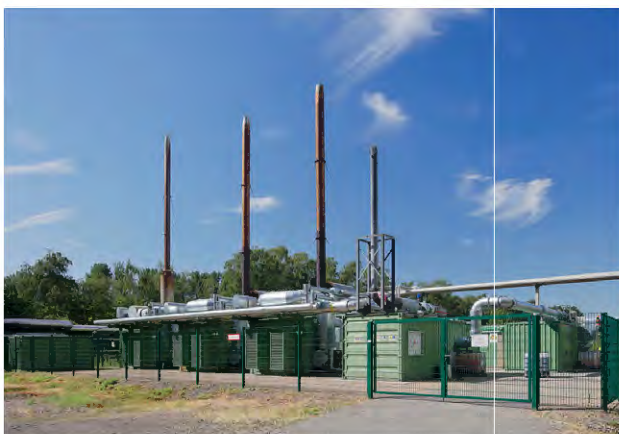
Bild 2.1 – Grubengasverwertungsanlage (Quelle: Friedhelm Krischer)
