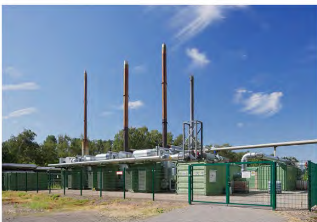
Bild 2.1 – Grubengasverwertungsanlage (Quelle: Friedhelm Krischer)
