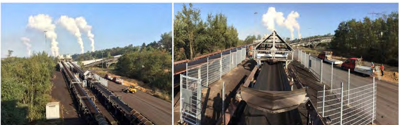
Bild 8.2 – Installationsort eines PGNAA-Analysators (Coalscan) im Bunker Fortuna (Bandanlage N123) des Tagebaus Garzweiler. Die Anlage wurde um einen Zaun und einen Brockenabweiser erweitert.
