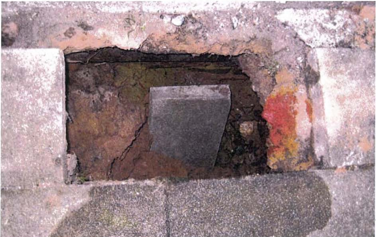
Bild 30: Straßeneinbruch im öffentlichen Verkehrsraum, Beispiel 5 [Foto: Stadt Gelsenkirchen]
