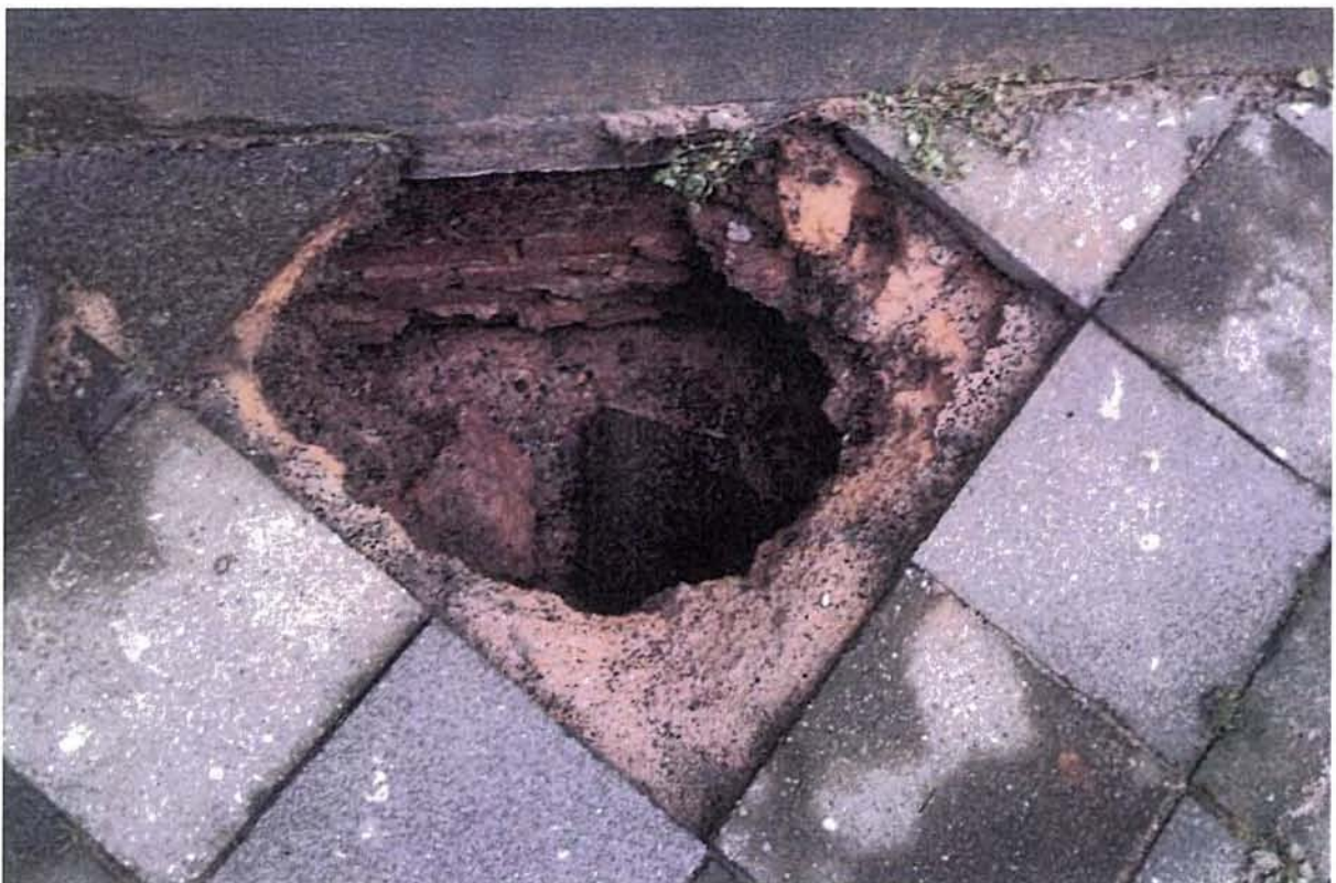
Bild 38: Straßeneinbruch im öffentlichen Verkehrsraum, Beispiel 13 [Foto: Stadt Gelsenkirchen]
