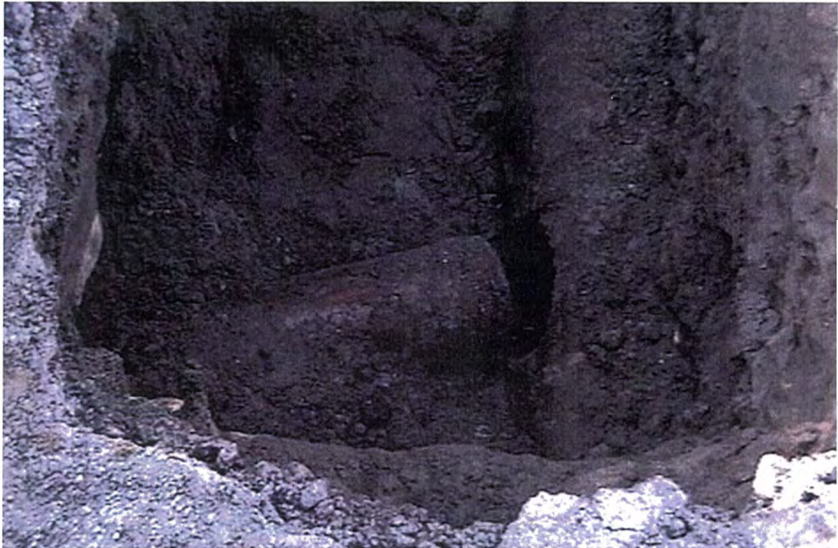
Bild 24: Freigelegte private Abwasserleitung im Bereich der Absackung aus Bild 22 - Anschluss defekt [Foto: Stadt Emmerich]
