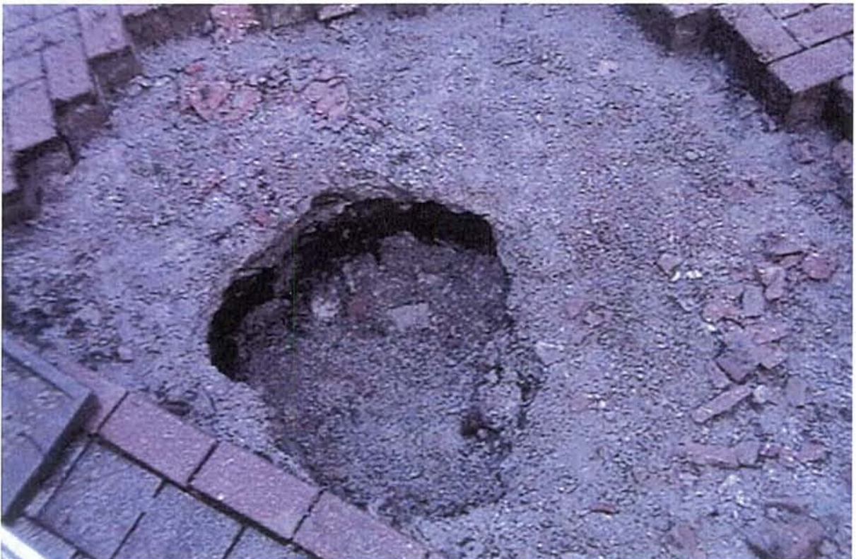
Bild 23: Absackung aus Bild 22 nach Aufnehmen des Pflasters [Foto: Stadt Emmerich]
