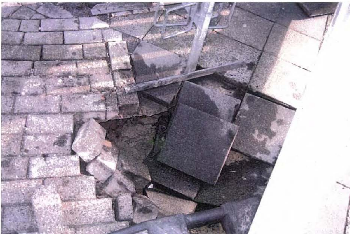
Bild 31: Straßeneinbruch im öffentlichen Verkehrsraum, Beispiel 6 [Foto: Stadt Gelsenkirchen]
