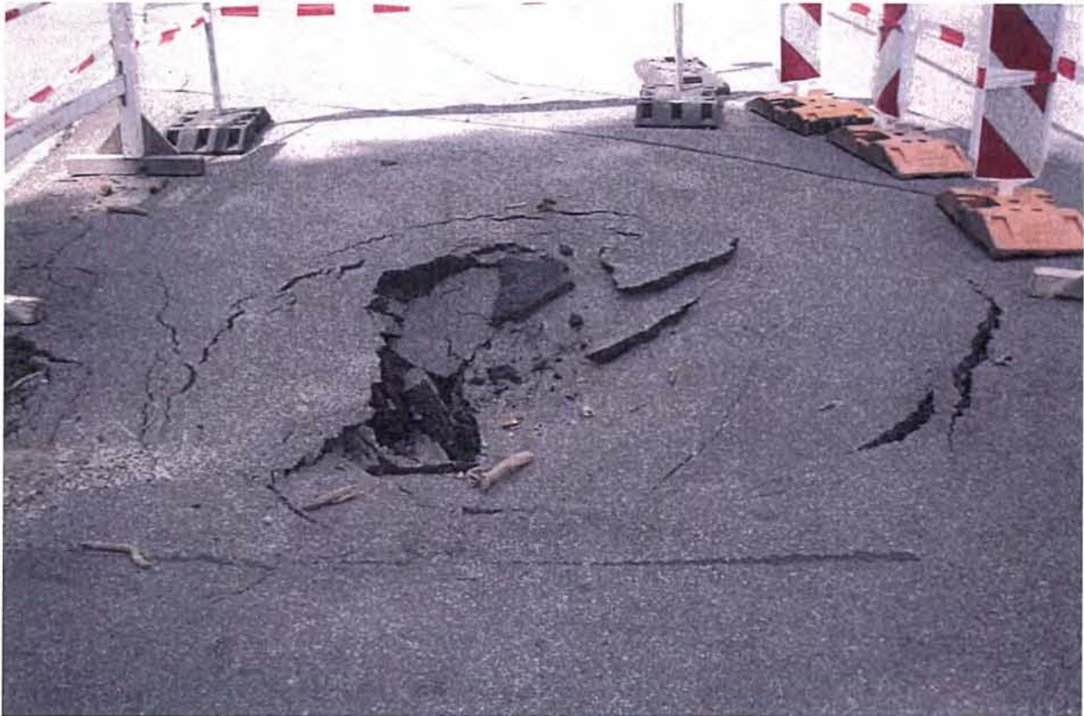
Bild 64: Absackung mit Straßeneinbruch im öffentlichen Verkehrsraum der Gemeinde Much [Foto: Ingenieurbüro Hartmann GmbH]
