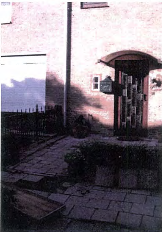
Bild 17: Absackung im Eingangsbereich [Foto: Stadt Emmerich]
