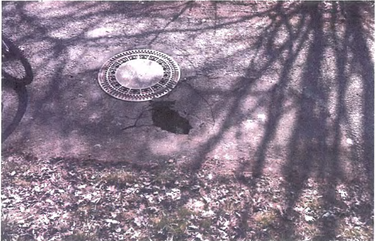
Bild 49: Straßeneinbruch im öffentlichen Verkehrsraum, Beispiel 1 [Foto: SEG Schwerte]
