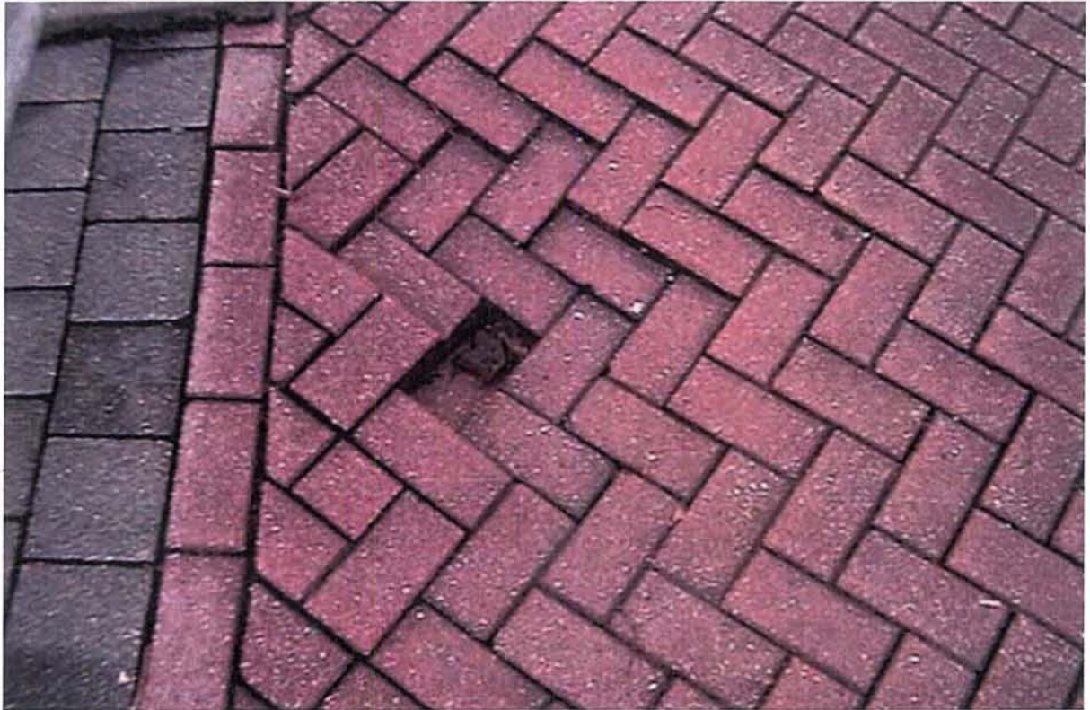
Bild 22: Absackung im Straßenpflaster eines verkehrsberuhigten Bereiches [Foto: Stadt Emmerich]
