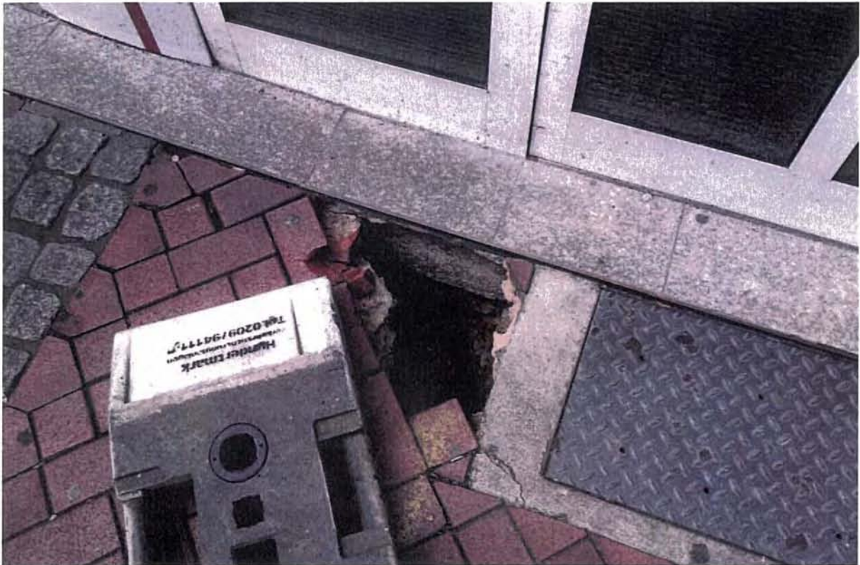
Bild 33: Straßeneinbruch im öffentlichen Verkehrsraum, Beispiel 8 [Foto: Stadt Gelsenkirchen]
