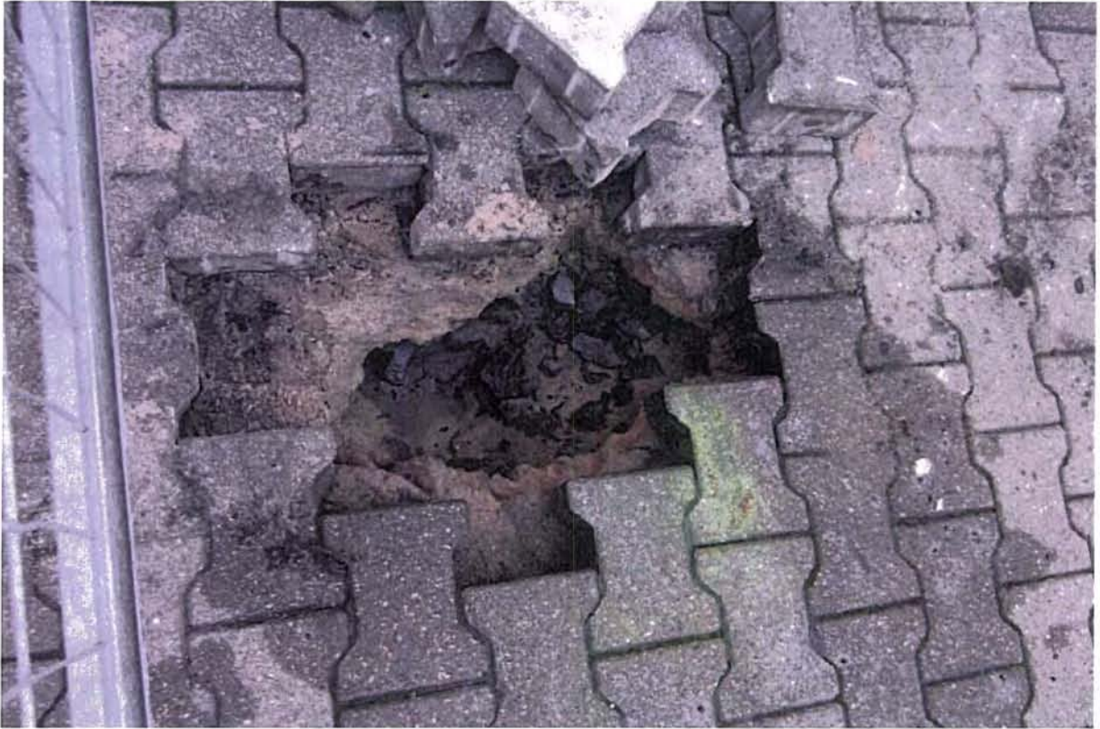
Bild 35: Straßeneinbruch im öffentlichen Verkehrsraum, Beispiel 10 [Foto: Stadt Gelsenkirchen]
