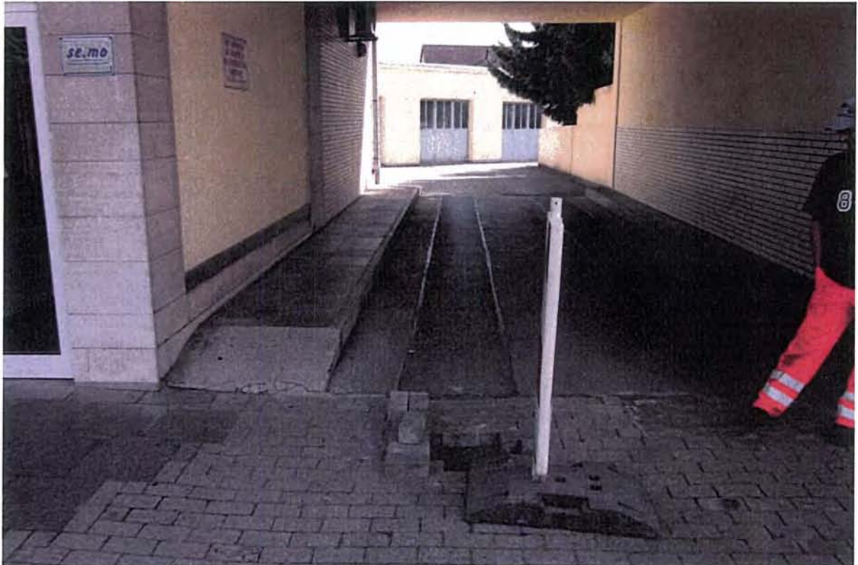
Bild 27: Straßeneinbruch im öffentlichen Verkehrsraum, Beispiel 3 [Foto: Stadt Gelsenkirchen]
