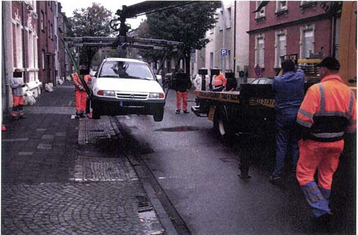
Bild 41: Straßeneinbruch im öffentlichen Verkehrsraum, Foto 2 [Foto: Stadt Hamm]
