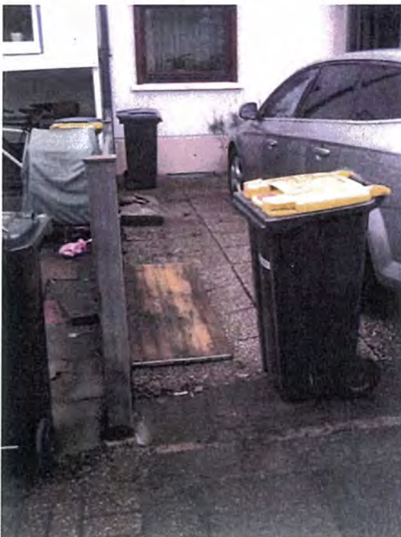
Bild 43: Absackung auf PKW-Stellfläche [Fotos: Abwasser-Service Volkner GmbH]
