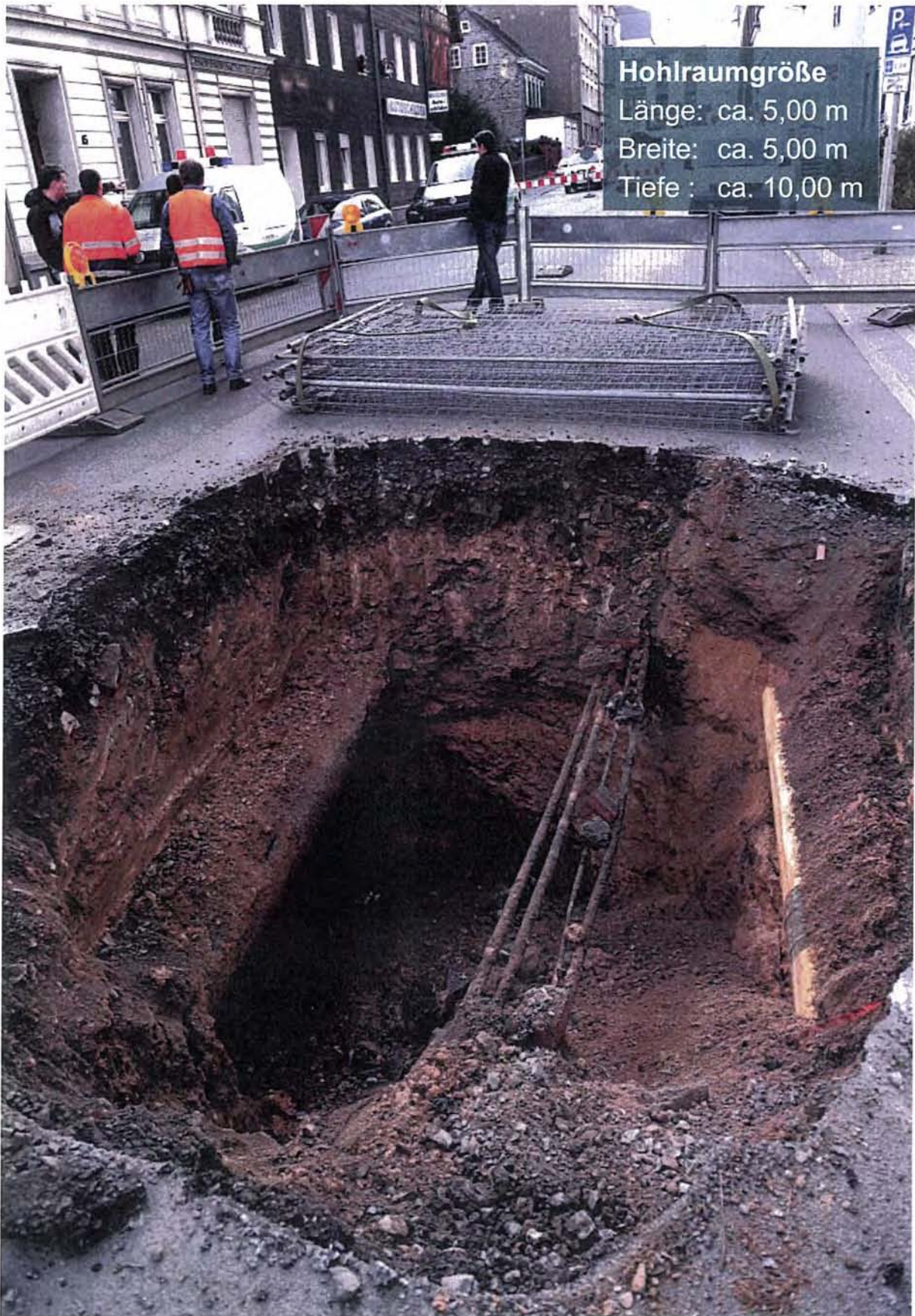
Bild 56: Freigelegter Hohlraum in der Gasstraße [Foto: Technische Betriebe Solingen]
