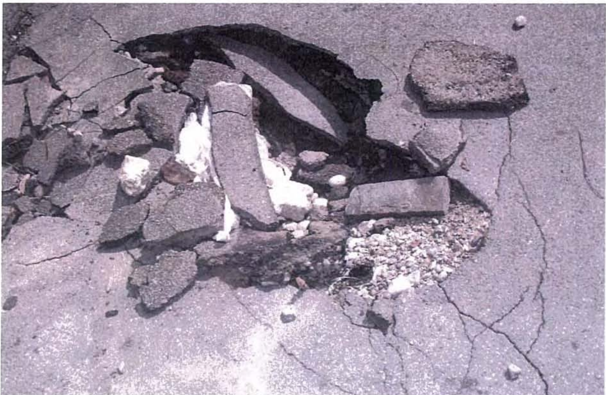
Bild 65: Straßeneinbruch im öffentlichen Verkehrsraum vor Schloss Neuschwanstein [Foto: Ingenieurbüro Hartmann GmbH]
