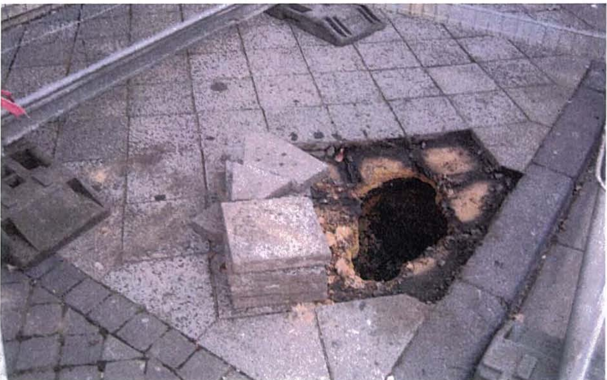
Bild 26: Straßeneinbruch im öffentlichen Verkehrsraum, Beispiel 2 [Foto: Stadt Gelsenkirchen]
