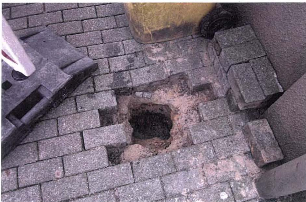
Bild 32: Straßeneinbruch im öffentlichen Verkehrsraum, Beispiel 7 [Foto: Stadt Gelsenkirchen]
