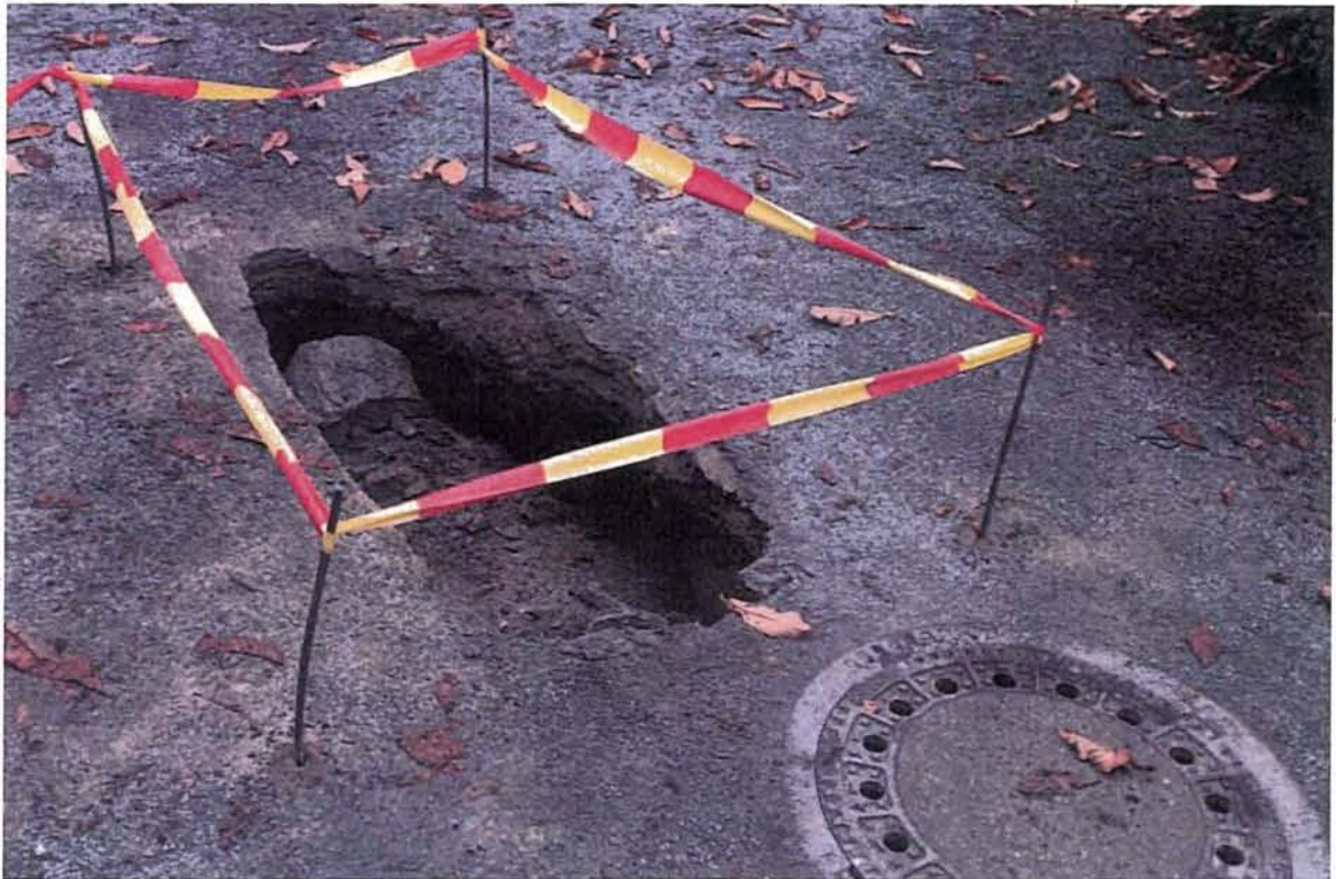
Bild 66: Absackung mit Bodeneinbruch auf einem privaten Grundstück in Castrop-Rauxel [Foto: Lobbe Entsorgung West GmbH & Co KG]
