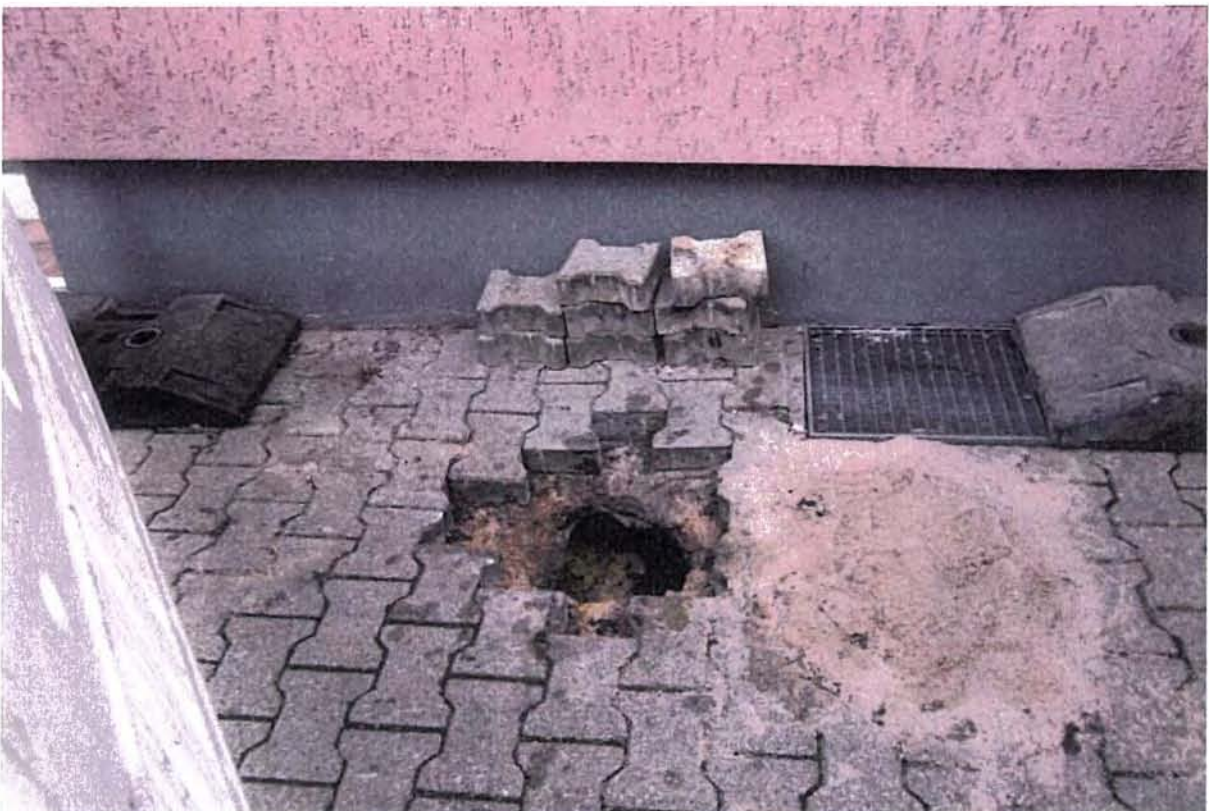
Bild 34: Straßeneinbruch im öffentlichen Verkehrsraum, Beispiel 9 [Foto: Stadt Gelsenkirchen]
