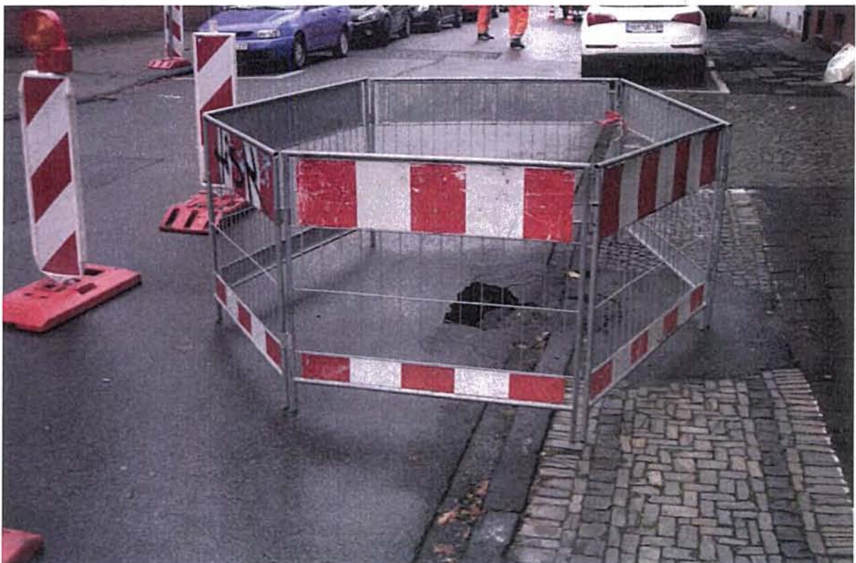
Bild 42: Straßeneinbruch im öffentlichen Verkehrsraum, Foto 3 [Foto: Stadt Hamm]
