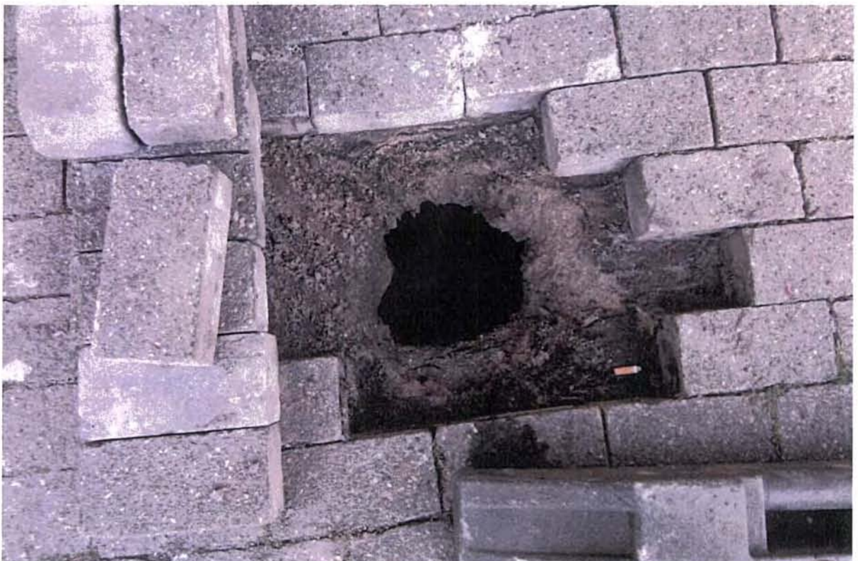
Bild 28: Hohlraum – Detailansicht zu Bild 27 [Foto: Stadt Gelsenkirchen]
