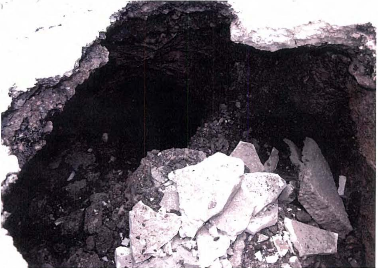
Bild 5: Hohlraum – Detailansicht zu Bild 4 [Foto: Stadt Alsdorf]
