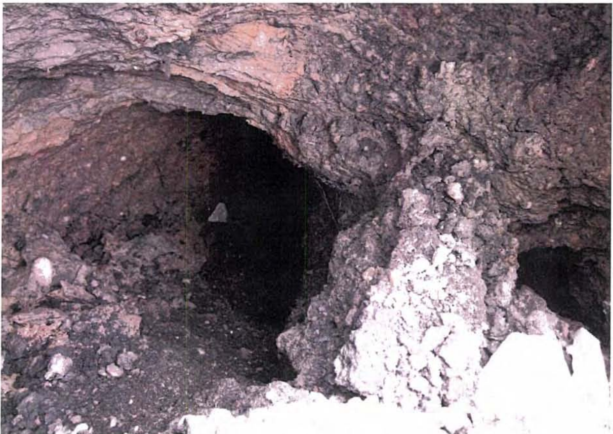
Bild 6: Hohlraum – Detailansicht zu Bild 4 [Foto: Stadt Alsdorf]
