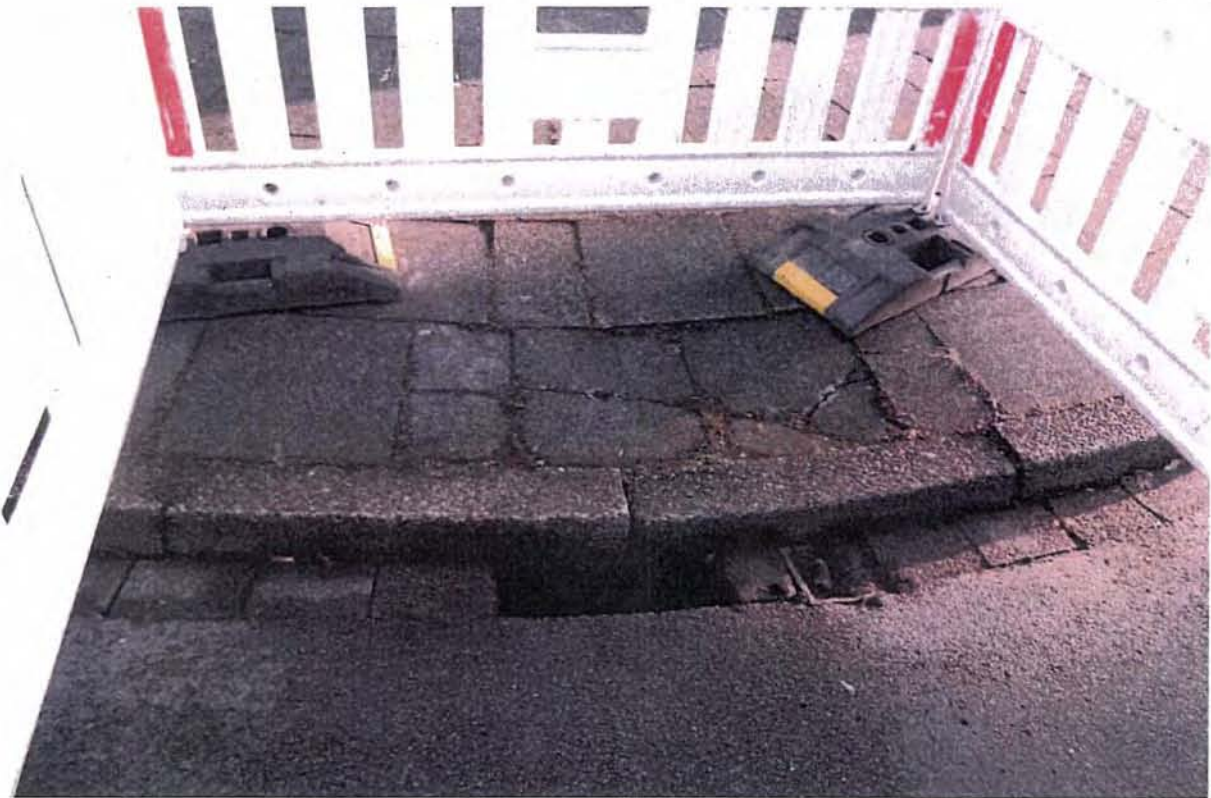
Bild 15: Straßeneinbruch im öffentlichen Verkehrsraum im Bereich des Bordsteins [Foto: Stadt Dortmund]
