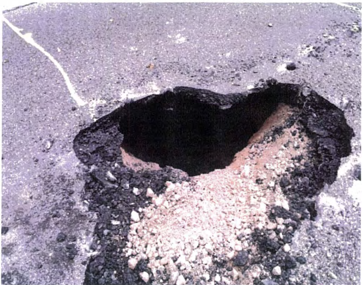
Bild 60: Straßeneinbruch mit unterirdischem Hohlraum in der Viehbachtalstraße [Foto: Technische Betriebe Solingen]
