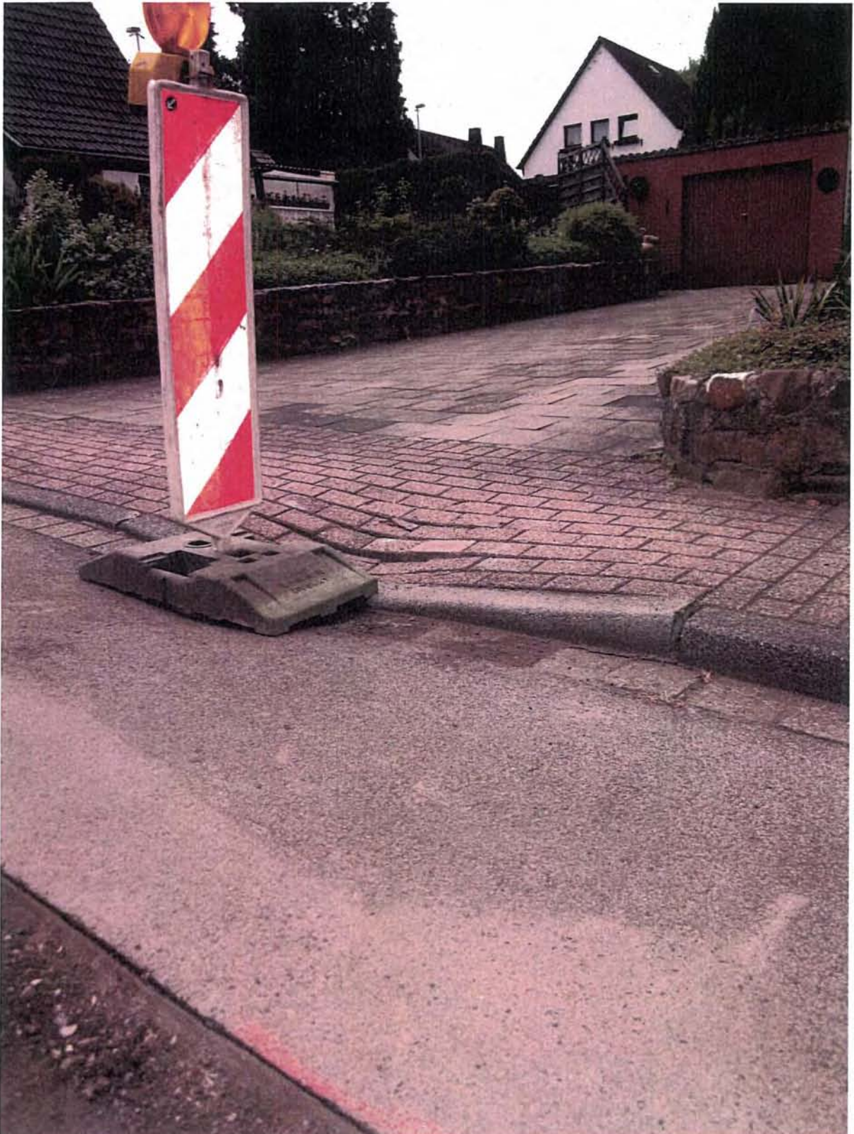
Bild 3: Absackung im Gehwegsbereich [Foto: Stadt Alsdorf]
