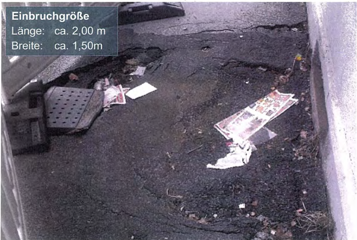
Bild 7: Straßeneinbruch im öffentlichen Verkehrsraum [Foto: Stadt Bochum]
