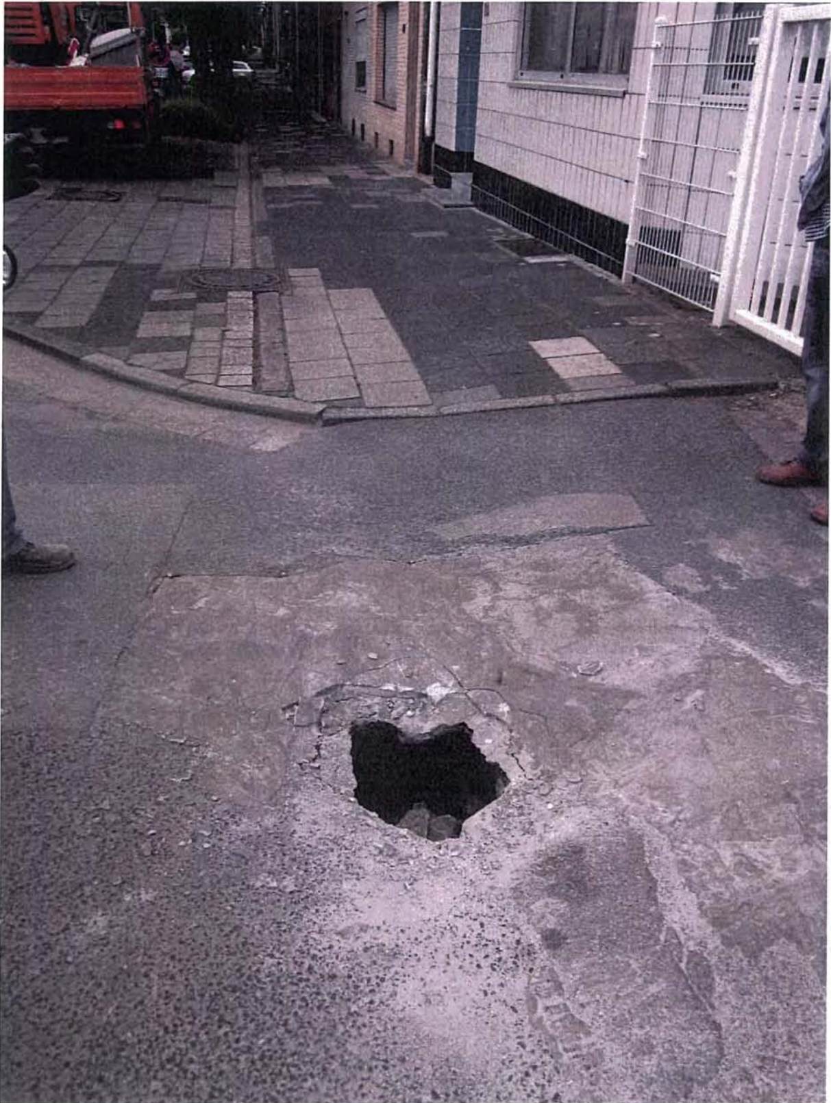
Bild 4: Straßeneinbruch im öffentlichen Verkehrsraum [Foto: Stadt Alsdorf]
