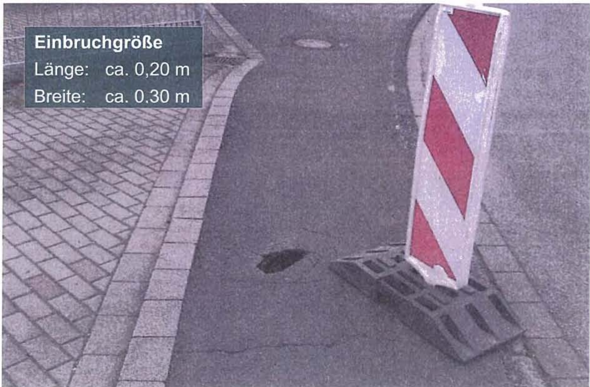
Bild 51: Straßeneinbruch im öffentlichen Verkehrsraum, Beispiel 3 [Foto: SEG Schwerte]
