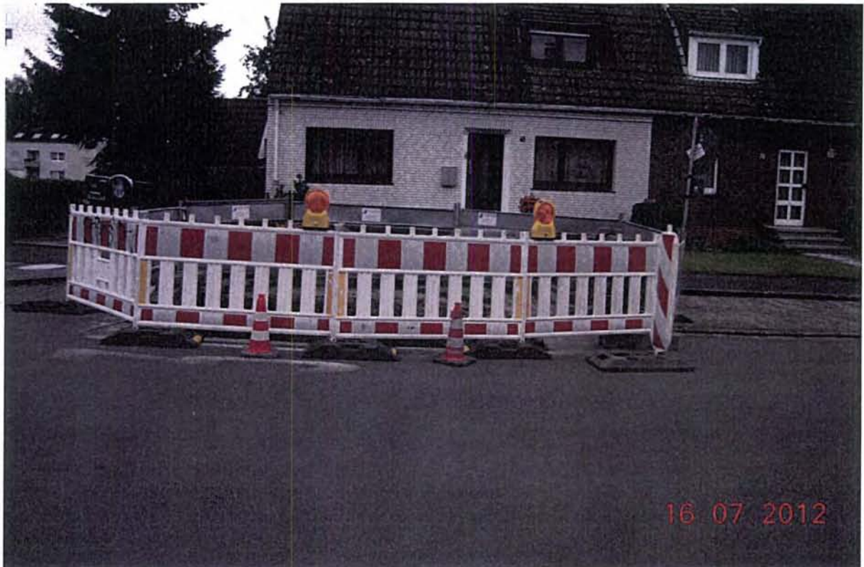
Bild 13: Baustelle an einem Straßeneinbruch im Dortmunder Stadtgebiet [Foto: Stadt Dortmund]
