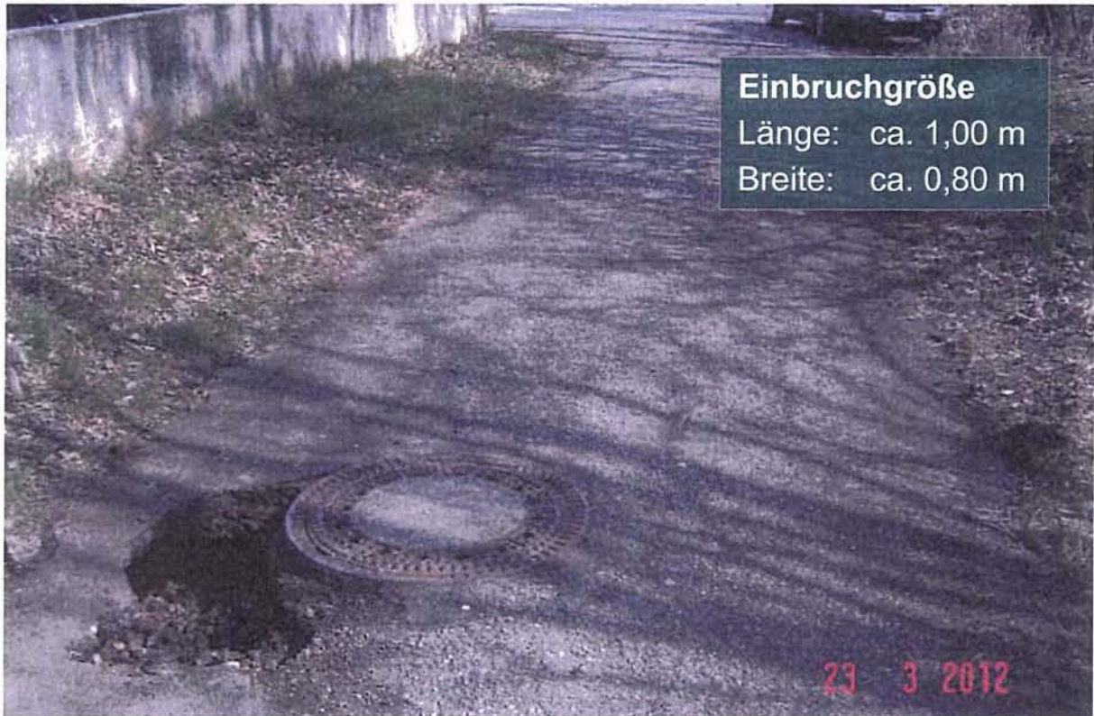
Bild 50: Straßeneinbruch im öffentlichen Verkehrsraum, Beispiel 2 [Foto: SEG Schwerte]
