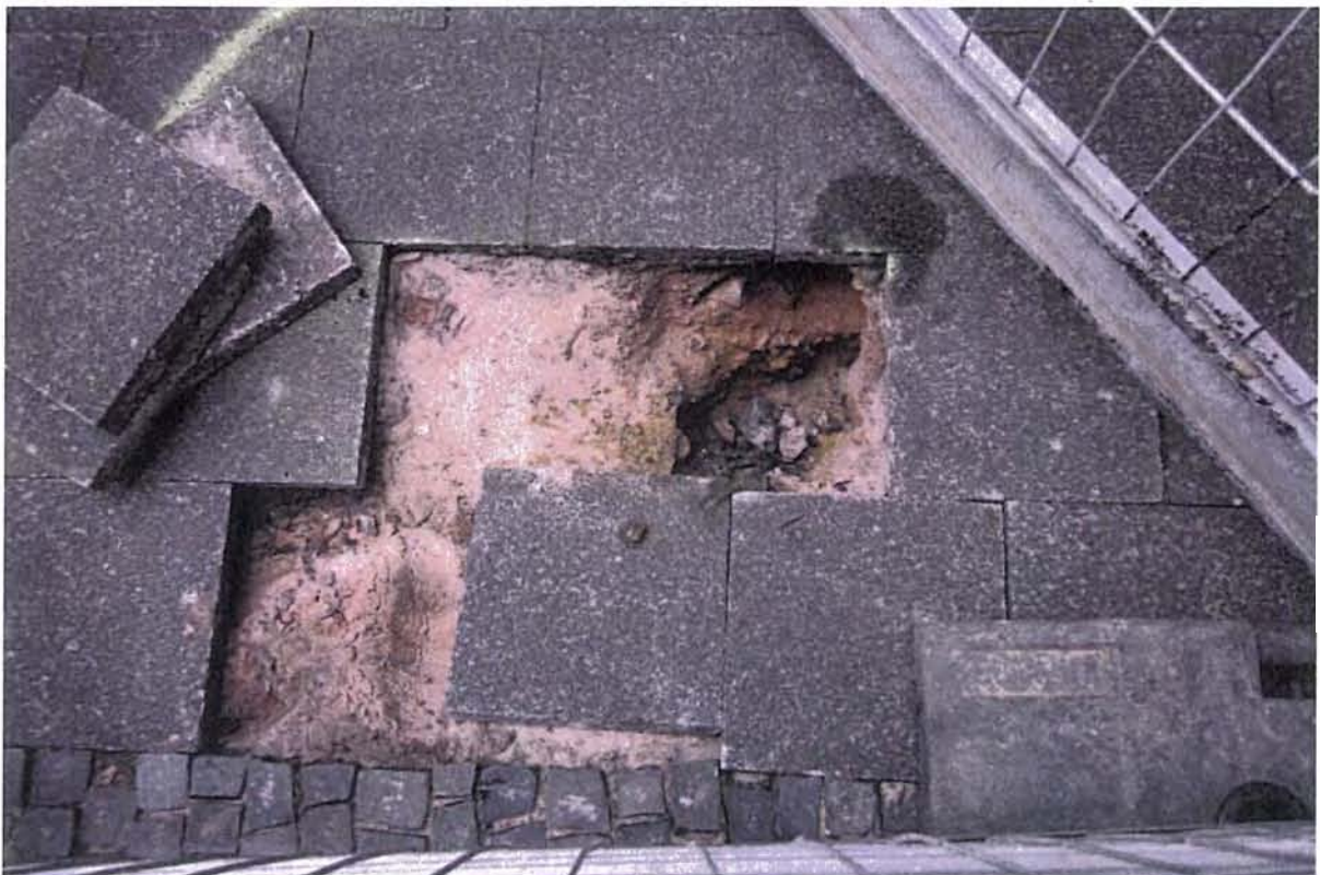
Bild 36: Straßeneinbruch im öffentlichen Verkehrsraum, Beispiel 11 [Foto: Stadt Gelsenkirchen]
