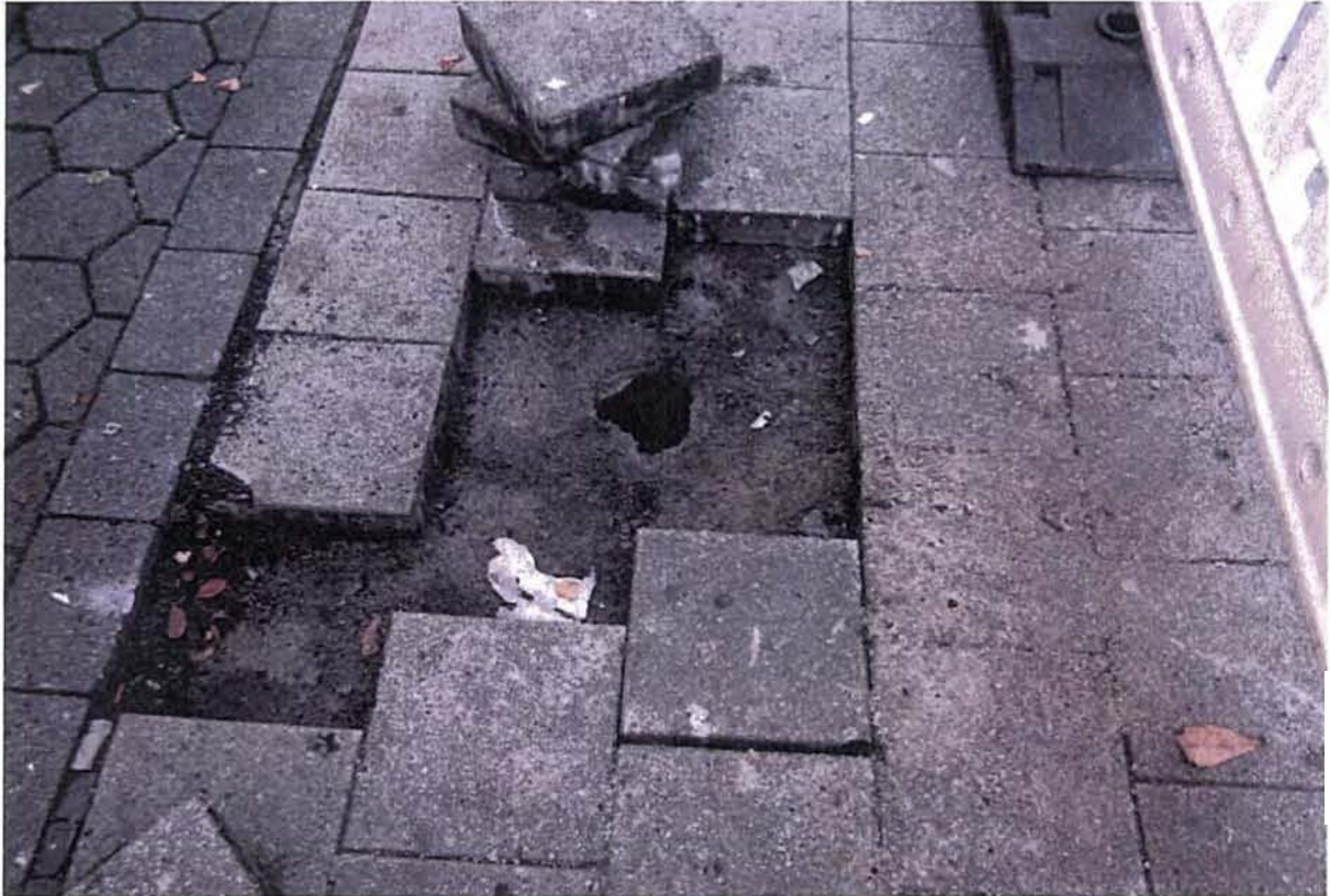
Bild 29: Straßeneinbruch im öffentlichen Verkehrsraum, Beispiel 4 [Foto: Stadt Gelsenkirchen]
