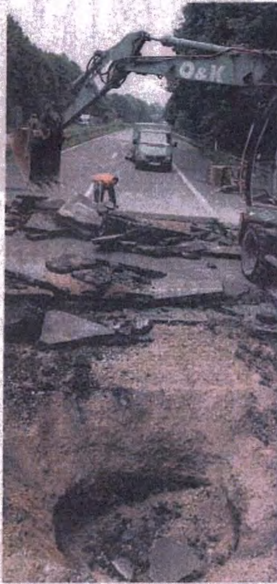
Schon nach Abheben der abgesackten Asphaltdecke tat sich ein tiefes Loch in der Fahrbahn auf, das sich später weiter vergrößerte. Foto: up
