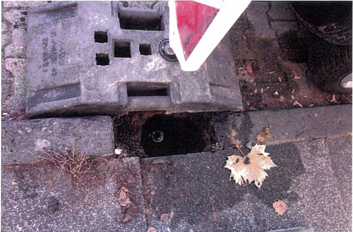
Bild 39: Straßeneinbruch im öffentlichen Verkehrsraum, Beispiel 14 [Foto: Stadt Gelsenkirchen]
