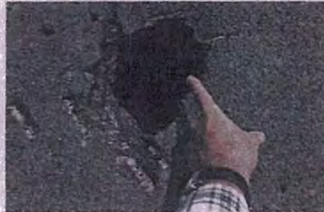
Das Loch unter dem Asphalt ist größer, als es zunächst scheint. Foto: cb
