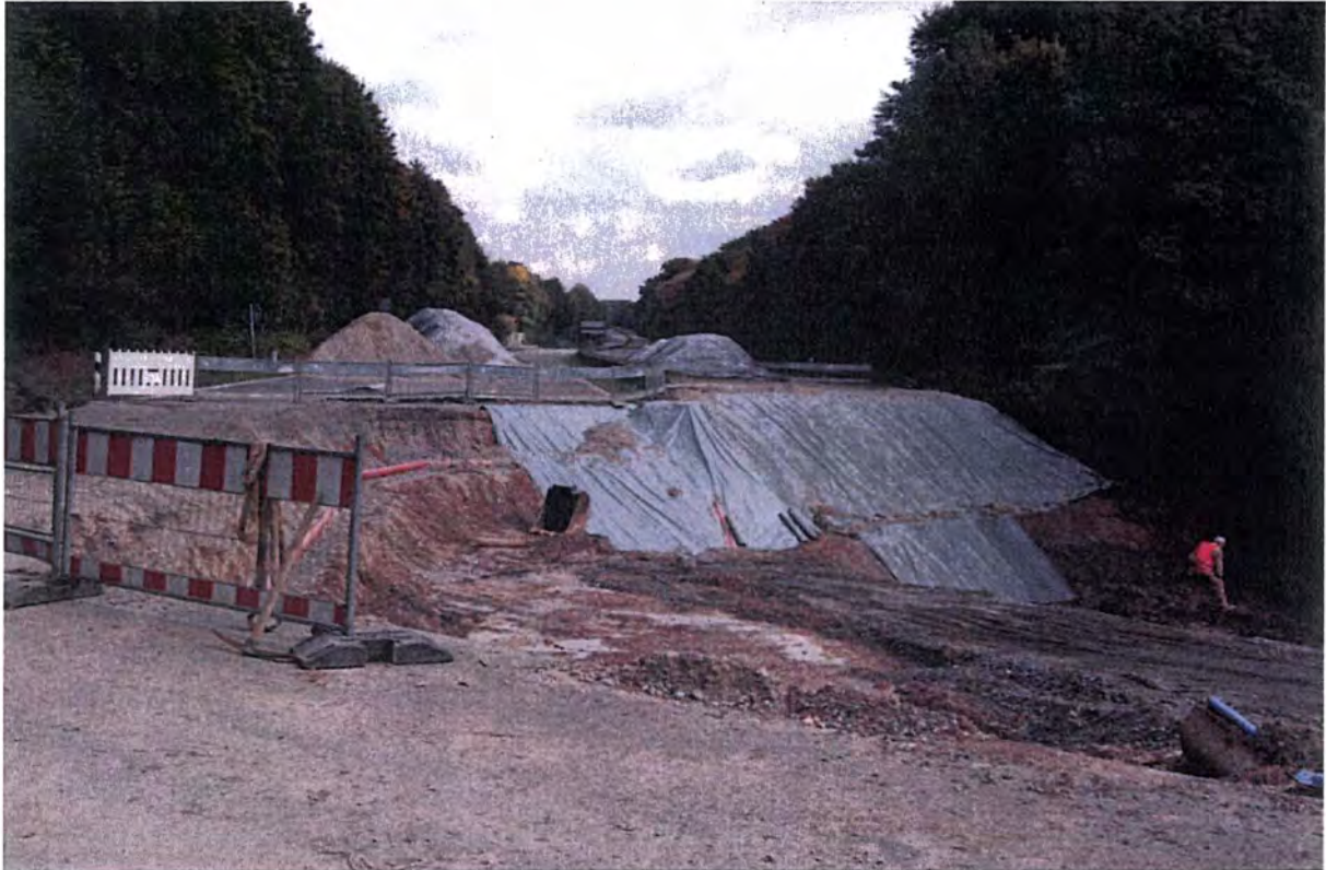
Bild 63: Ansicht der Baustelle auf der Viehbachtalstraße infolge des unterirdischen Hohlraums [Foto: Technische Betriebe Solingen]
