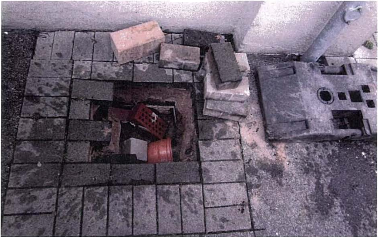
Bild 25: Straßeneinbruch im öffentlichen Verkehrsraum, Beispiel 1 [Foto: Stadt Gelsenkirchen]
