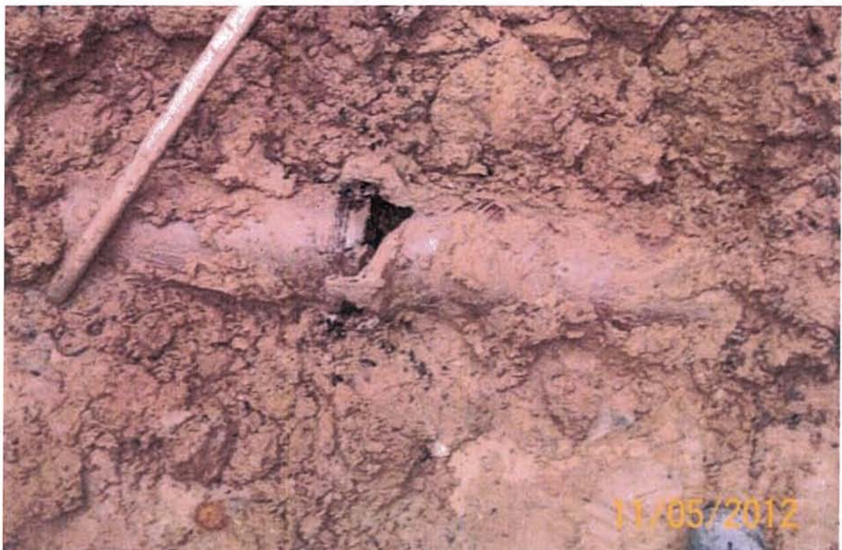
Bild 14: Detailansicht zu Bild 13 – freigelegte defekte Hausanschlussleitung [Foto: Stadt Dortmund]
