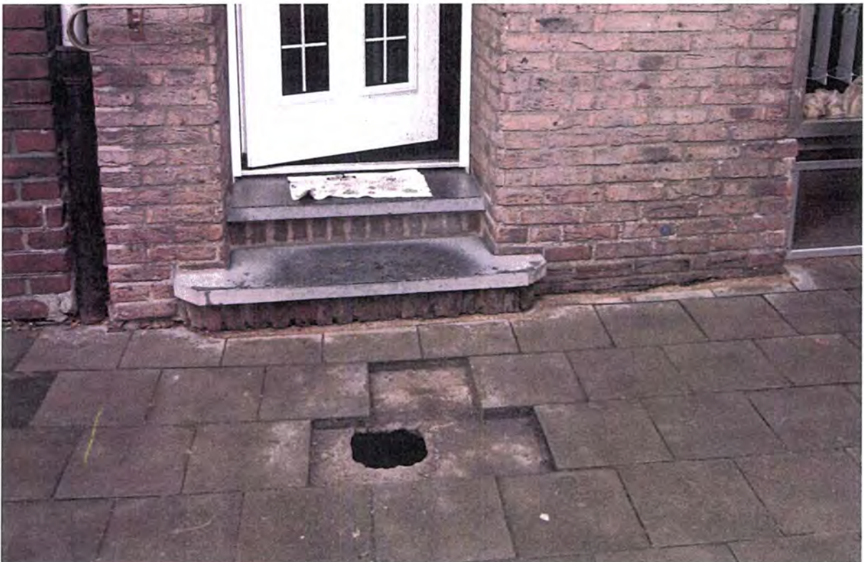
Bild 1: Absackung im Gehwegsbereich mit Hohlraumbildung [Foto: Stadt Alsdorf]
