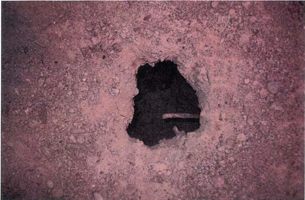
Bild 47: Straßeneinbruch mit unterirdischem Hohlraum im öffentlichen Verkehrsraum [Foto: Abwasser-Service Volkner GmbH]
