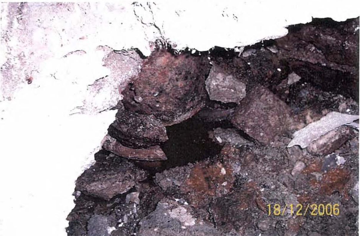
Bild 46: Hohlraum unter der Bodenplatte – Detailansicht zu Bild 45 [Foto: Abwasser-Service Volkner GmbH]
