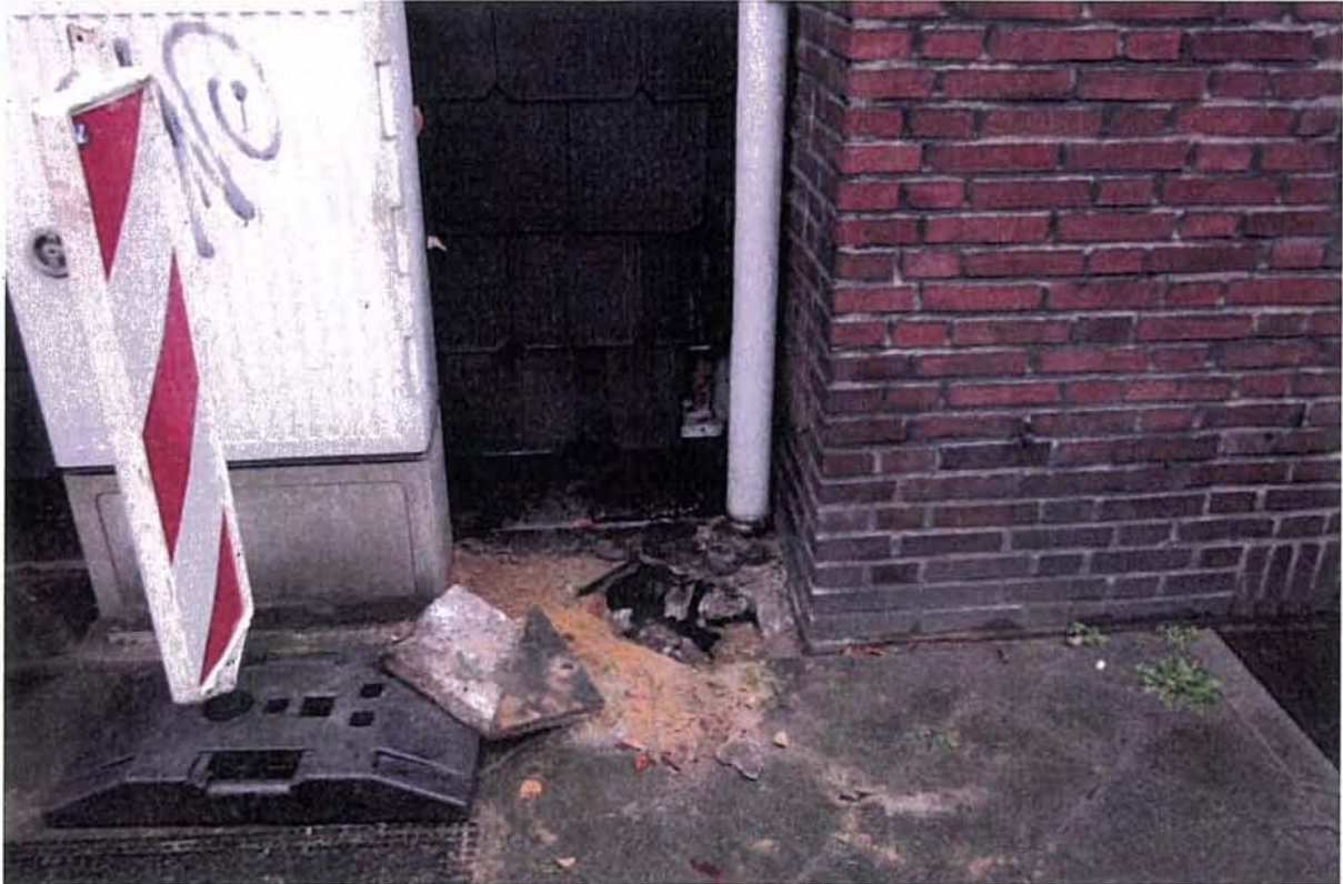
Bild 37: Straßeneinbruch im öffentlichen Verkehrsraum, Beispiel 12 [Foto: Stadt Gelsenkirchen]
