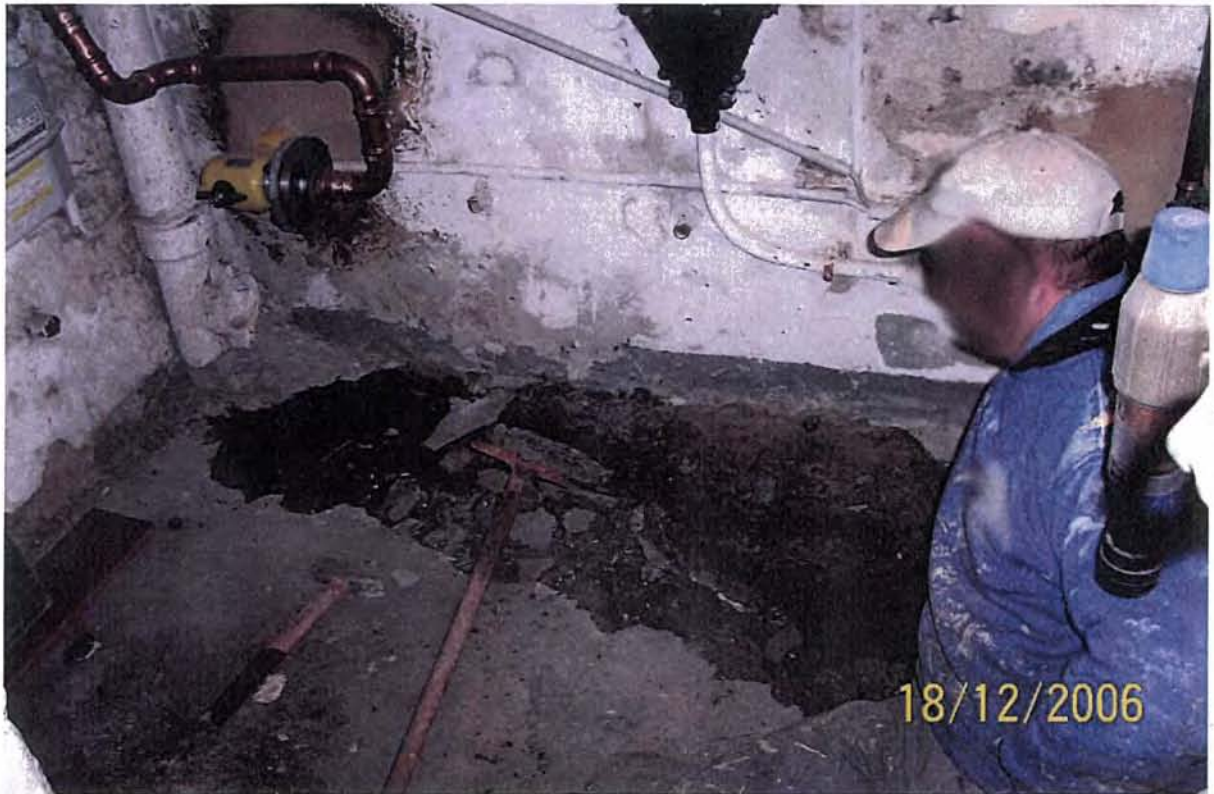
Bild 45: Bodeneinbruch im Keller eines Wohnhauses verursacht durch defekte private Abwasserleitung [Foto: Abwasser-Service Volkner GmbH]
