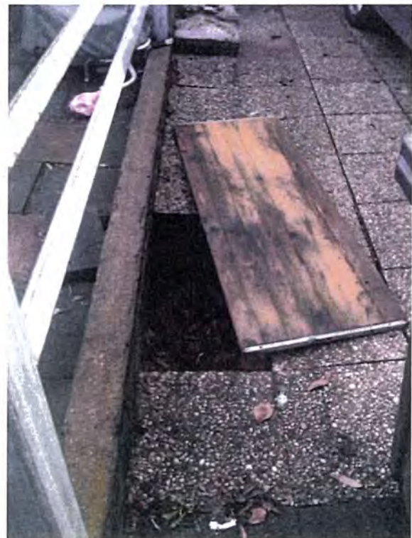
Bild 44: Hohlraum – Detail zu Bild 43
