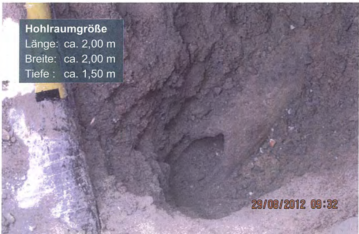
Bild 52: Freigelegter Hohlraum in der Kasparstraße, obere Rohrhälfte der Abwasserleitung in Teilbereichen nicht mehr vorhanden [Foto: Technische Betriebe Solingen]
