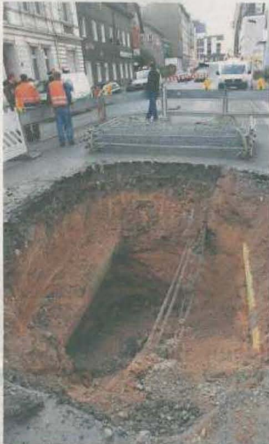
Etwas fünfeinhalb Meter ist das Loch in der Gasstraße an seiner tiefsten Stelle. Am Freitag hatten es die Entsorgungsbetriebe komplett freigelegt und die dort liegenden Leitungen überprüft. Jetzt ist es abgedeckt. FOTO: KEMPFER
