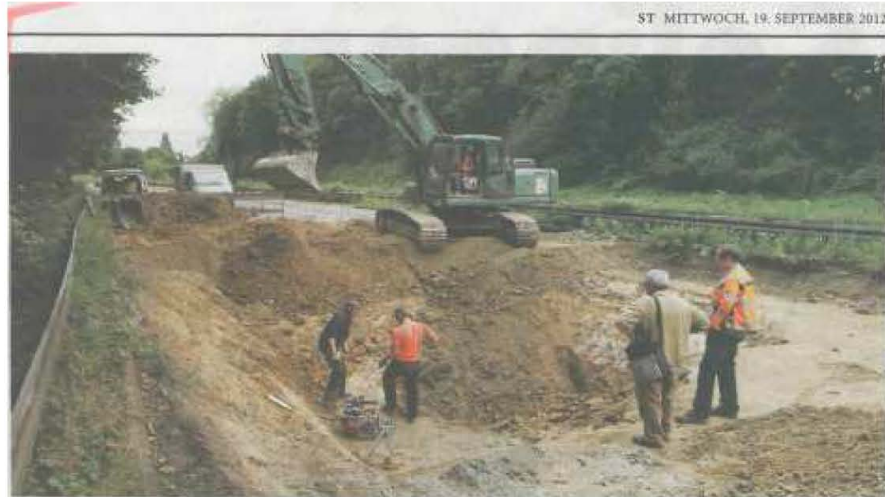
Über die beiden Fahrspuren Richtung Solingen rollen eigentlich täglich rund 22.000 Fahrzeuge. Gestern standen im inzwischen 20 Meter langen, 13 Meter breiten und über fünf Meter tiefen Krater Mitarbeiter eines Kölner Gutachterbüros und führten Sondierungsbohrungen durch. Fotos: Christian Beier
